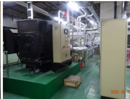
【環電張江廠】 空壓機節能改造
