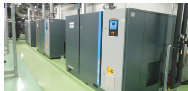
SPIL 中科廠 - 導入高效率真空機組
